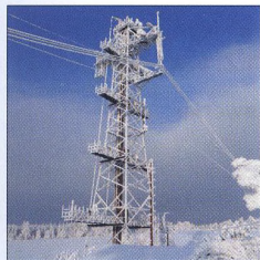
Námrazová stanice EGÚ Brno, a.s. ve Studnicích u Nového Města na Moravě. Stanice ve Studnicích slouží k výzkumu tvorby námrazy a souvisejících klimatických podmínek, měření hmotnosti a hustoty námrazy v závislosti na výšce nad zemí. Mimo to slouží
